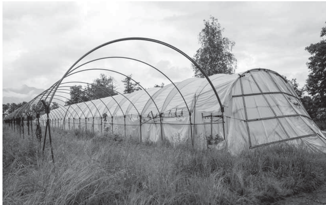
Il “tunnel” è stato danneggiato dal favonio l’autunno scorso. Presto se ne costruirà uno nuovo.
